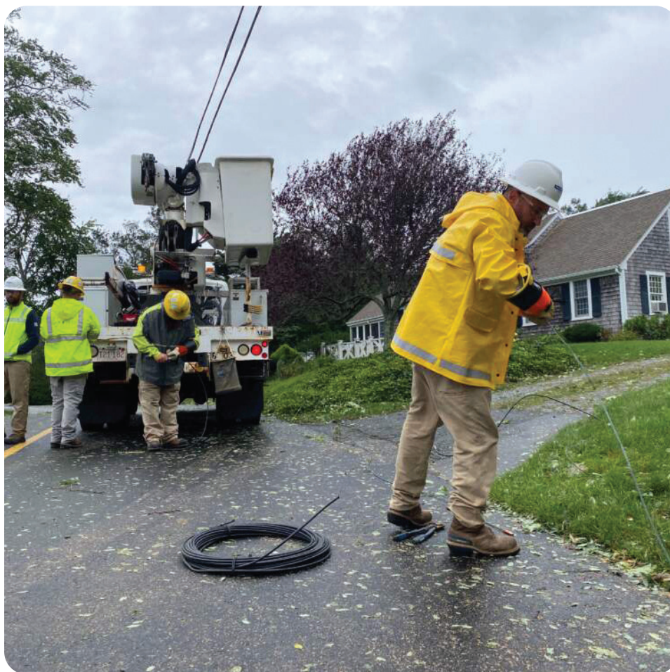
Contratistas de Eversource reparan una línea eléctrica dañada por la caída de un árbol en Brewster.
